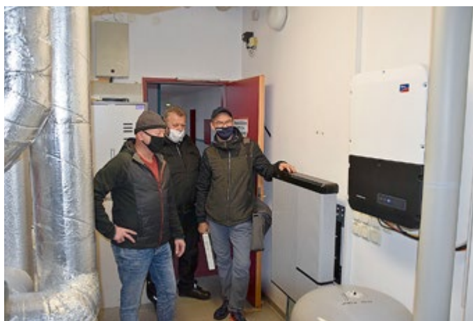
v.l.n.r. Harry Ellenberger, Schul-Hausmeister Holger Grenzer und Sven Fricke nehmen gemeinsam den neuen Batteriespeicher der PV-Anlage im Henfling-Gymnasium in Meiningen in Betrieb.
