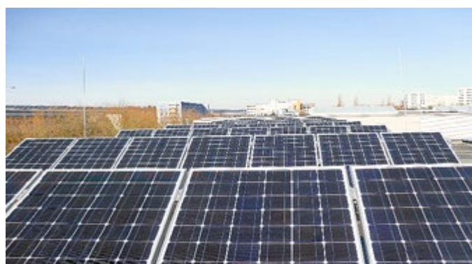
PV-Anlage auf dem Dach von Haus 4 des Landratsamtes in Meiningen.
