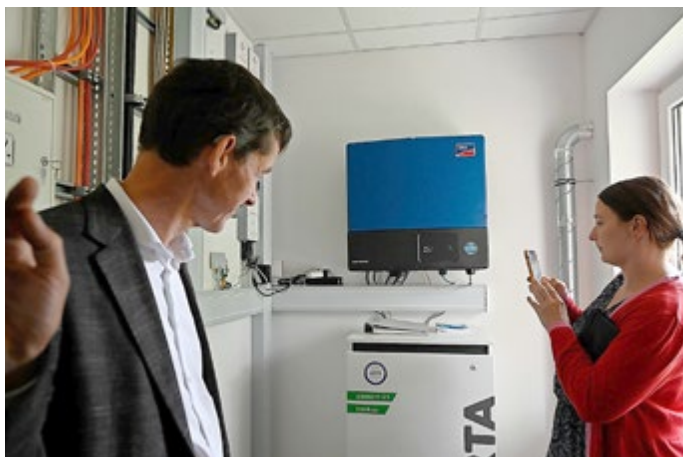
Blick auf den Batteriespeicher: Damit der produzierte Strom der 59 PV-Module auf dem Dach auch zu sonnenarmen Zeiten abgerufen werden kann, wurde ein Batteriespeicher mit einer Kapazität von 16,5 kWh installiert.
