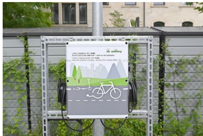
Auch eine Ladesäule für E-Bikes wird auf dem Parkplatz am Standort Charlottenstraße vorgehalten.
